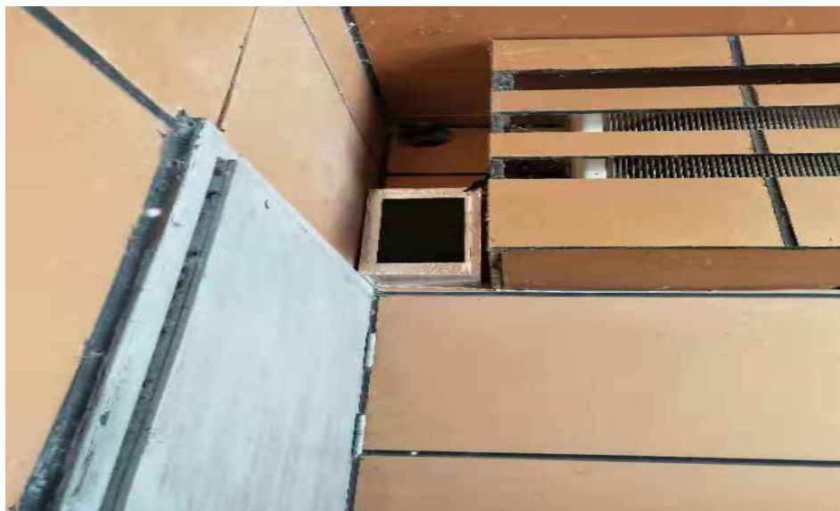
活性炭处理装置及废气排放口
